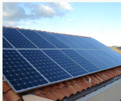
光伏发电系统
