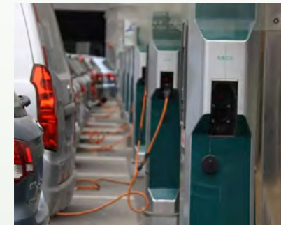
充电桩(站)专用
